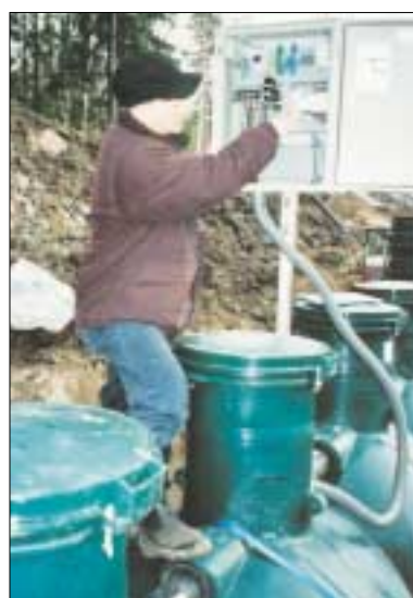
Automatiikka säätelee puhdistustoimintoja ja ilmoittaa kemikaalien lisäystarpeesta.
